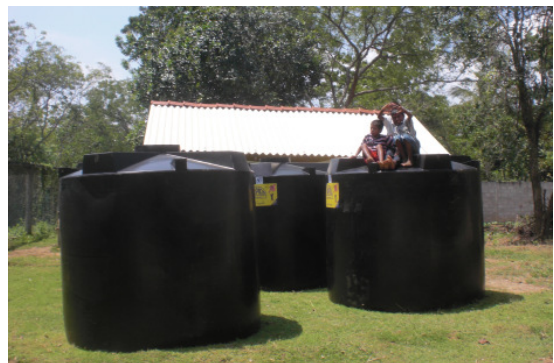
3 Wassertanks für den Wasserspeicher
